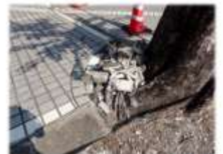
■外構：タイルのひびわれ・浮き
